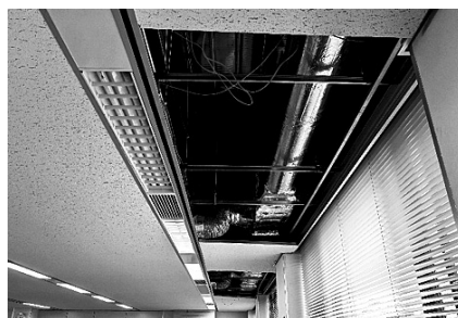
崩落した庁舎天井部分
