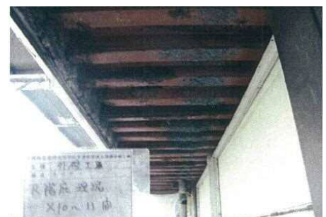
耐震補強工事で露出した軒下に吹き付けられた青石綿。気づかず放置された（金岡高校）
