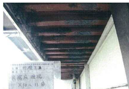
耐震補強工事で露出した軒下に吹き付けられた青石綿。気づかず放置された(金岡高校)
