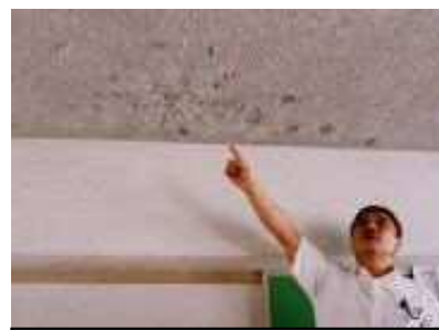
子ども達が突いたりして破損している吹き付けアスベスト
